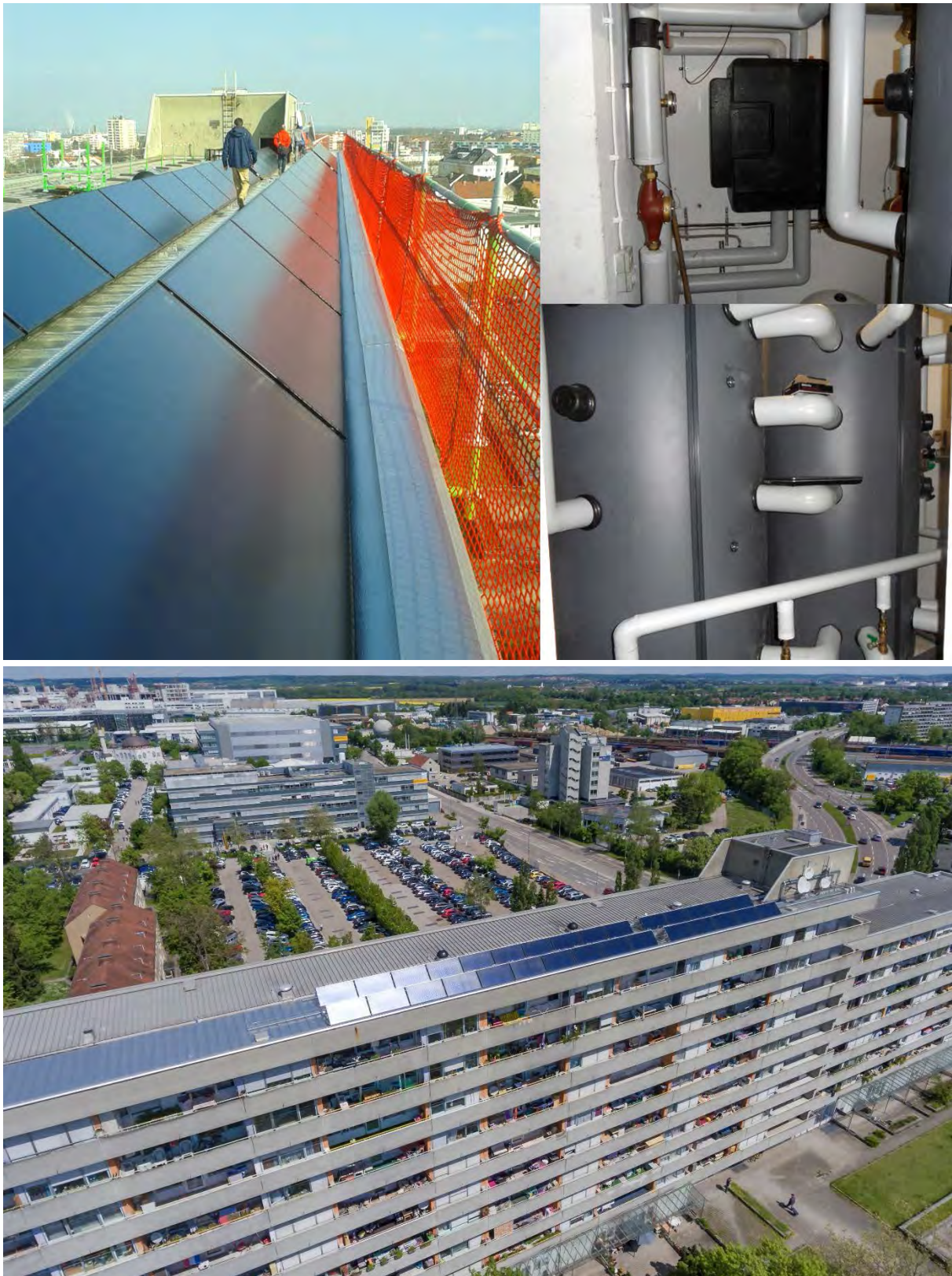
Abbildung 3-23: HB57 40° aufgeständertes Kollektorfeld auf Flachdach (links), Solarstation (oben rechts), kommunizierende Pufferspeicher (mitte rechts) im Keller sowie Gesamtansicht des Objekts (unten)
