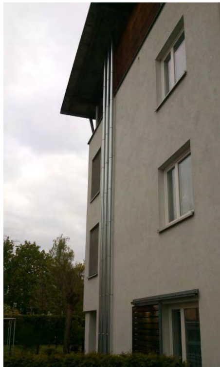
Abbildung 3-26: SB21 Außenliegende Kollektorkreisverrohrung (Vorlauf, Rücklauf und Leerrohr für Sensorkabel)
