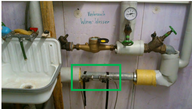
Abbildung 3-9: Erfassung des Warmwasser-Zapfprofils durch Clamp-On Ultraschall-Durchflusszähler am Kaltwasserzulauf zum Vorwärm Speicher
