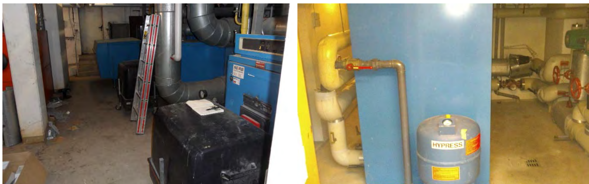
Abbildung 3-5: Heizzentrale (links) und beispielhafte Unterstation (rechts)
