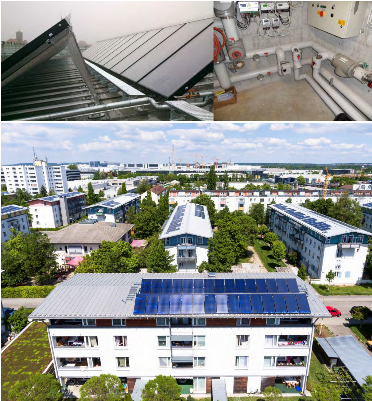
Abbildung 3-25: SB21 40° aufgeständerte Kollektoren auf Süddach (links oben), Regler, Messtechnik und Einspeisung in den Wärmenetzrücklauf des Gebäudes (rechts oben) sowie Gesamtansicht (unten)
