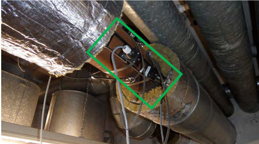
Abbildung 3-38: Ultraschall-Durchflusszähler am Hauptrücklauf des Wärmenetzes der Hindenburgstraße 57
