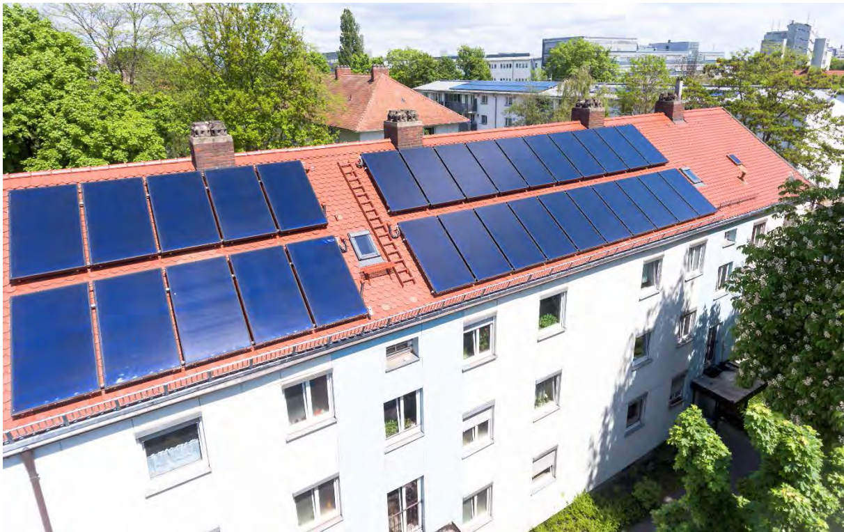
Abbildung 3-22: HB36 vier parallele Kollektorfelder auf Satteldach (links), Solarstation zwischen Primärkreis und Nahwärmerücklauf (rechts), Gesamtansicht (unten)
