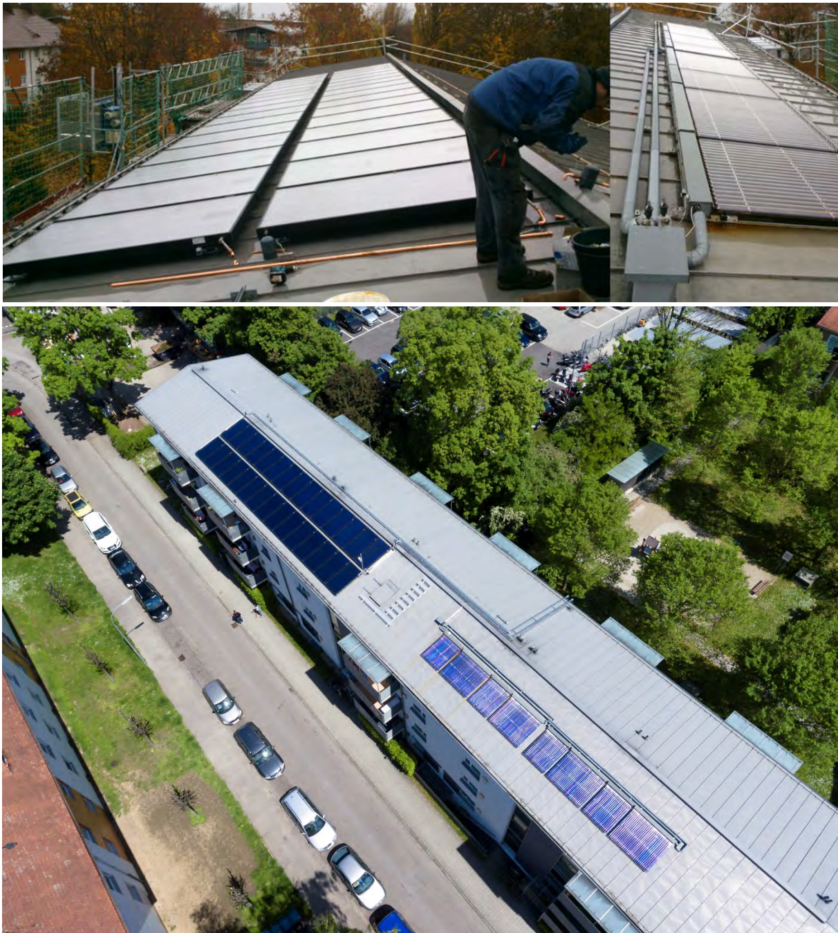
Abbildung 3-24: SB12 neu installierte Flachkollektoren (links oben), bestehende Vakuumröhrenkollektoren (rechts oben) auf Westdach sowie Gesamtansicht (unten)
